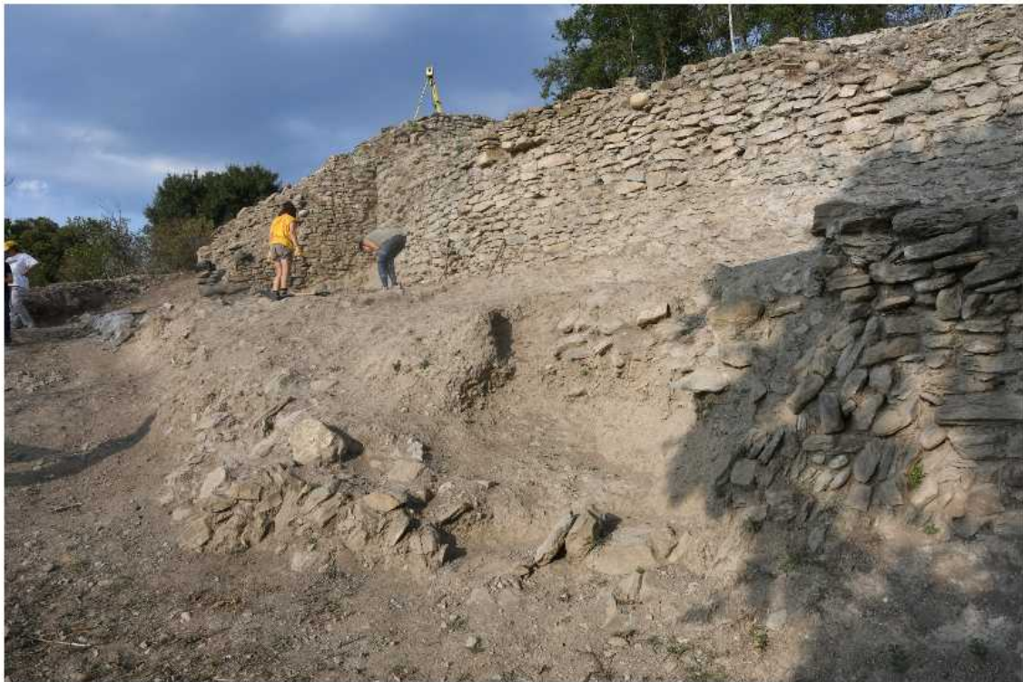
Estructures molt degradades, de la rampa d'accés a la poterna. Agost 2019.
